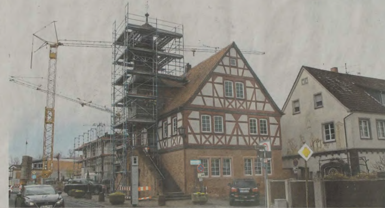
Rathaus Froschhausen: 150 000 Euro sind für die Sanierung vorgesehen.
